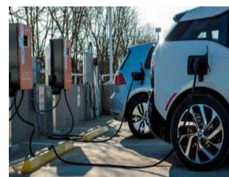
Зарядные станции для электромобилей
